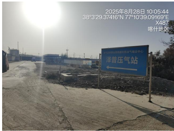
泽普压气站现状
